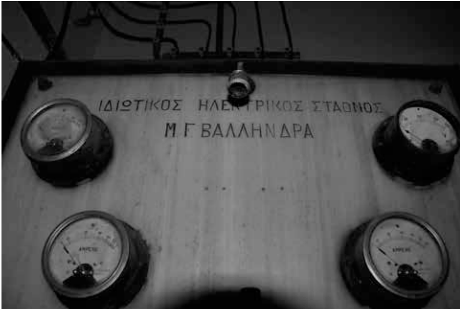
Εικ. 18 Λεπτομέρεια από τον ηλεκτρικό πίνακα διανομής με τα αμπερόμετρα. ©Αρχείο Θ. Μπιλή – Μ. Μαγνήσαλη.
